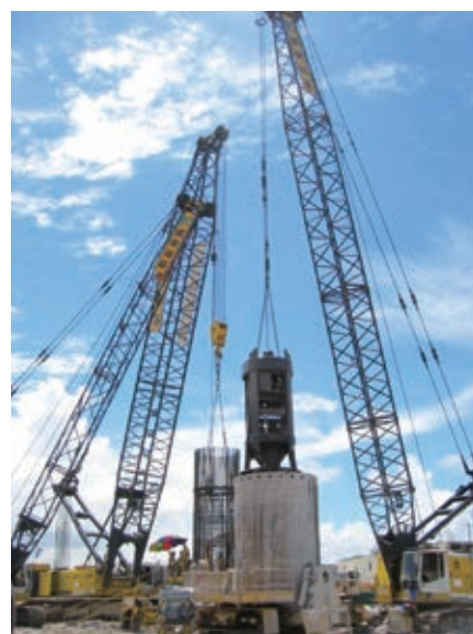
建業地基有限公司承建於一個建築地盤之鑽孔灌注樁工程
